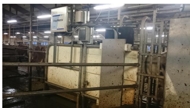
Foto 5: Instalación del Stepmatrix – vista lateral (H. Kiiver)
